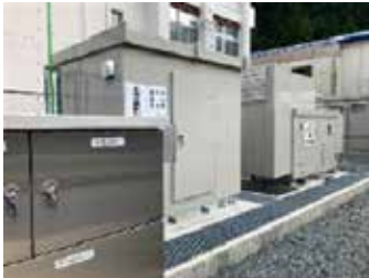
・非常用発電機（イメージ）
