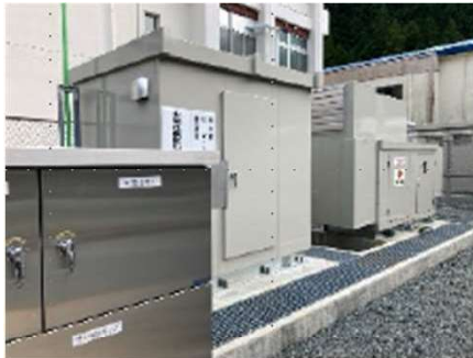
・非常用発電機（イメージ）
